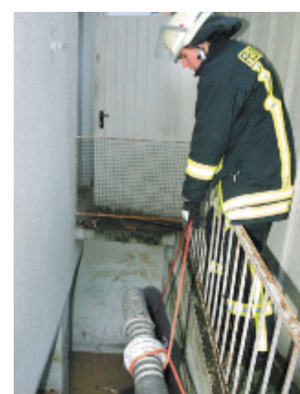
Schweres Gerät: Mit Pumpen nahm die Feuerwehr den Kampf gegen das Wasser auf.
