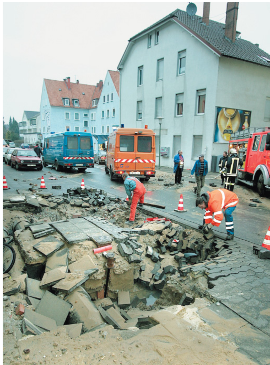
Die Macht des Wassers: Nach dem Rohrbruch schoss das Wasser durch das Pflaster in die Luft, floss über die Ernst-Rein-Straße ins Nachbarhaus und anschließend weiter die Meller Straße hinunter.
